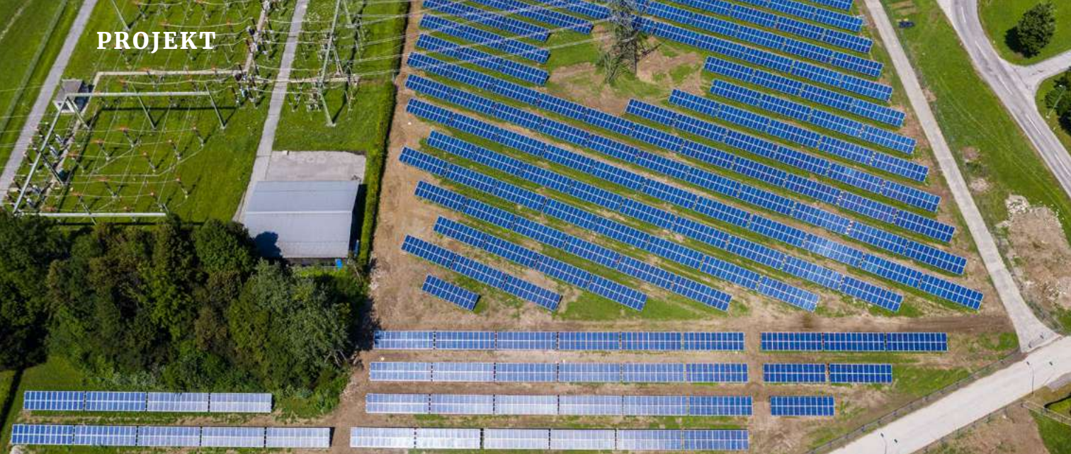
PV-Anlage in Feistritz, Foto: Verbund AG
