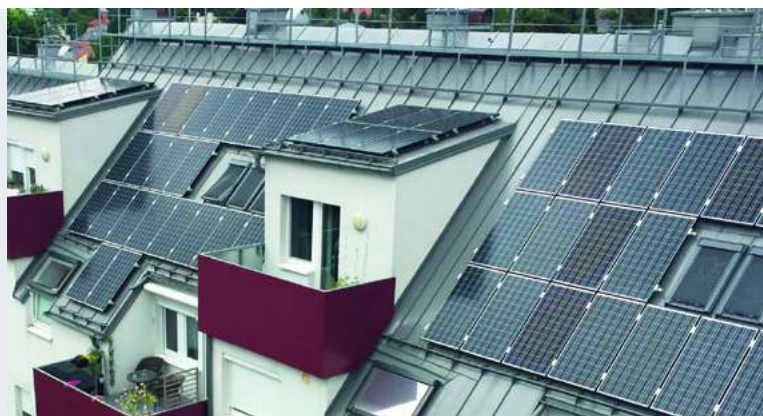
PV-Anlage Wien Stammersdorf, Foto: PV Austria
